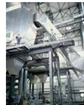
→ la fin du process de l'UVE où les fumées sont analysées grâce au système COPER-DIOX
