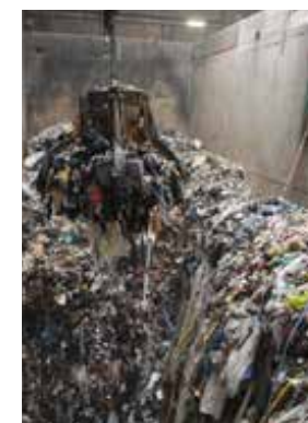
→ le grappin dans la fosse à déchets en charge d'alimenter les fours
