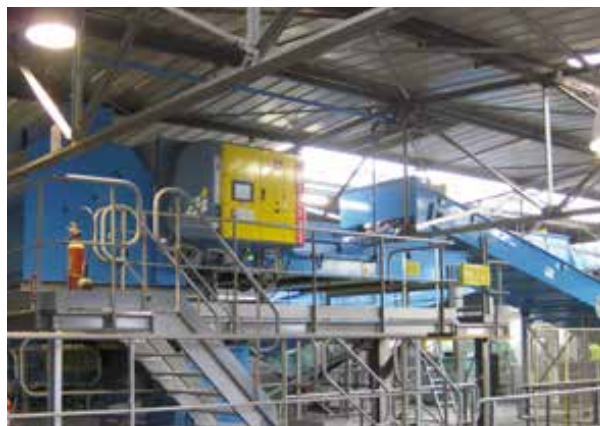
→ les machines de tri optique
