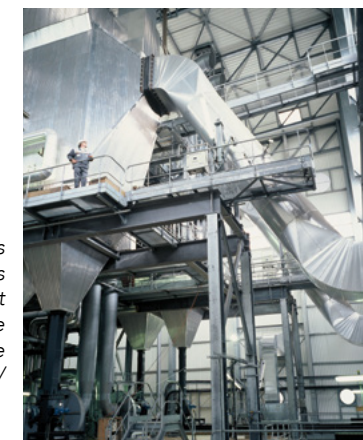
/ la fin du processus de l'UVE où les fumées sont analysées grâce au système COPER-DIOX /
